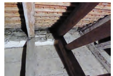
Mauerlatte ohne Hinterlüftung
